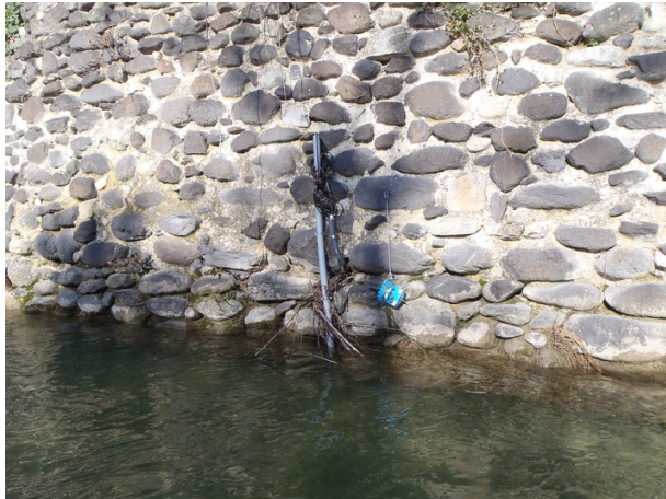
Station hydrométrique détruite par la crue
